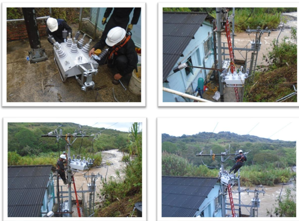
Grafica No. 44: Suministro e instalación de Reconectador PCH Ovejas
