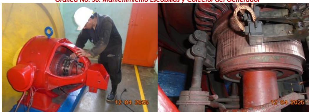
Grafica No. 58: Mantenimiento Escobillas y Colector del Generador
