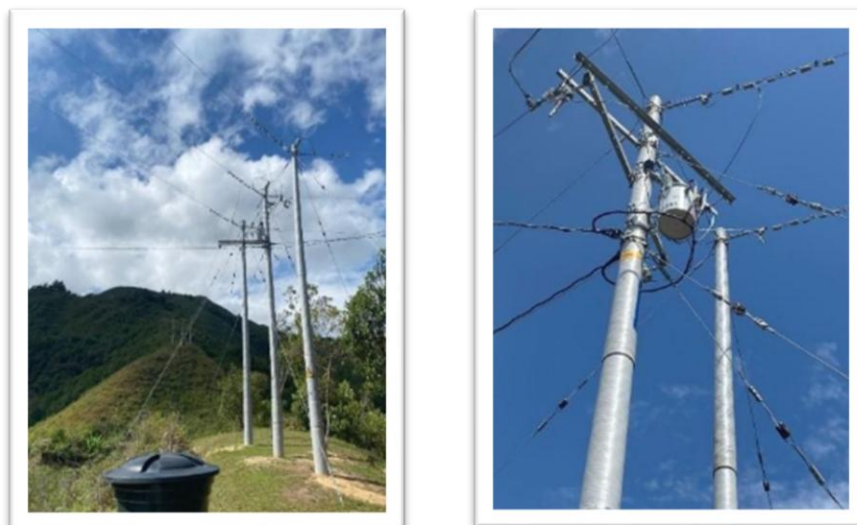
Grafica No. 64: Estructuras, retenidas centro y de transformación, con tendido de red de media y baja tensión - vereda la Honda.
