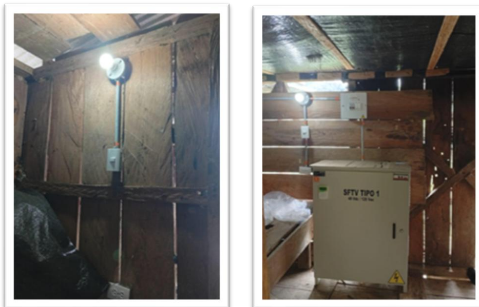
Grafica No. 61: Instalaciones internas en Argelia
