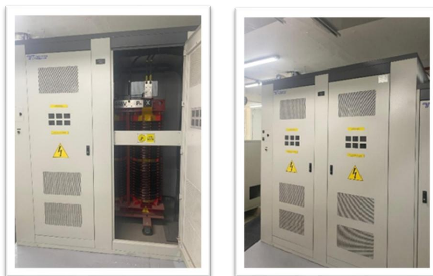
Grafica No. 68: Celda de seccionamiento y transformador seco subestación 500 KVA Hospital Susana López
