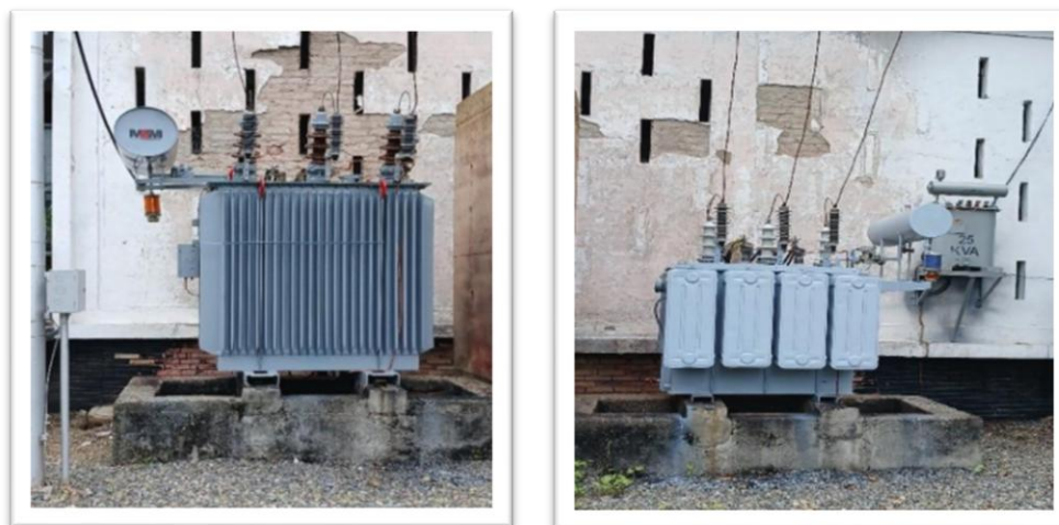
Grafica No. 41: Funcionamiento óptimo de transformadores potencia No1 y No2 en PCH RIO PALO
