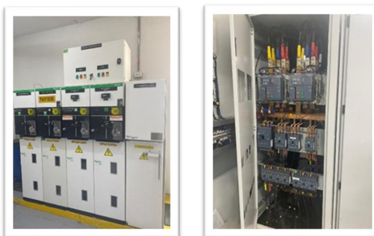
Grafica No. 69: Seccionador con fusible de media tensión y tablero de baja tensión Hospital Susana López
