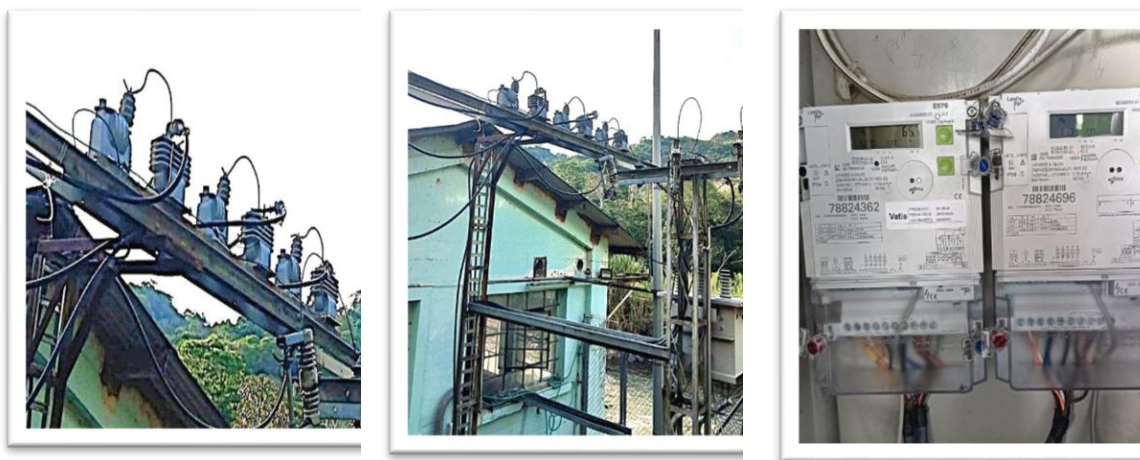
Gráfica No. 43: Reposición de transformadores de potencial y medidores de frontera en PCH OVEJAS
